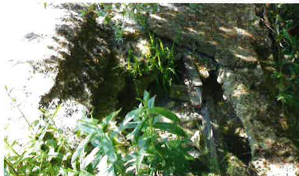
Figure 31. Trou dans le coursier aval
