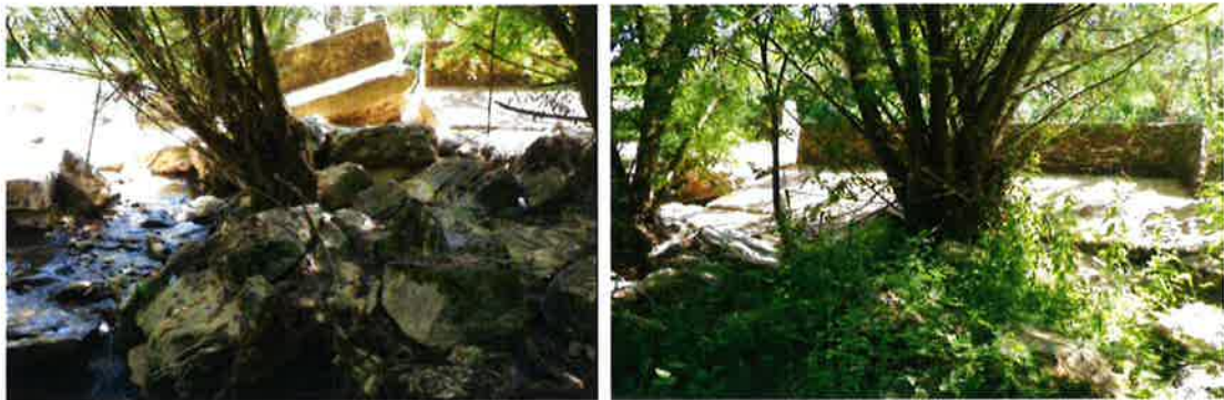
Figure 32. Développement de Saules au sein des enrochements libres constitutifs du coursier aval
