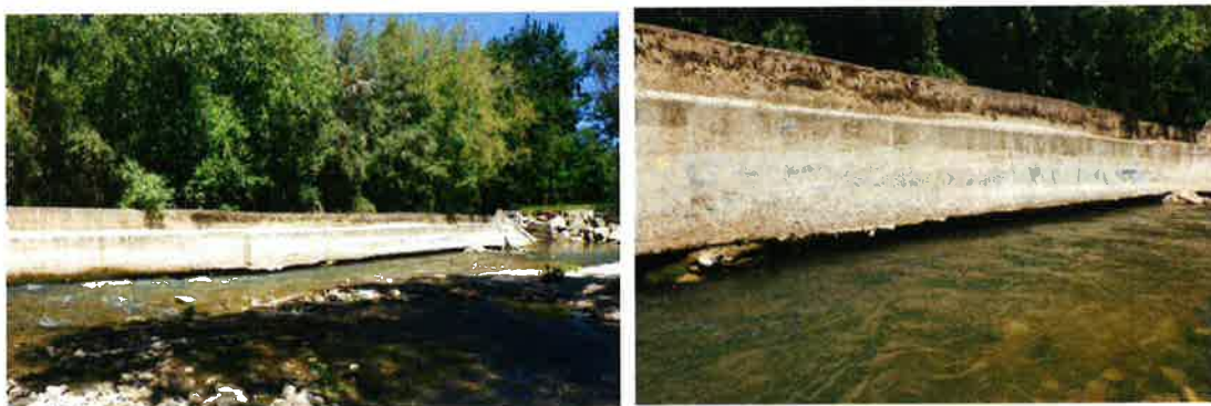
Figure 28. Affouillement généralisé du barrage
