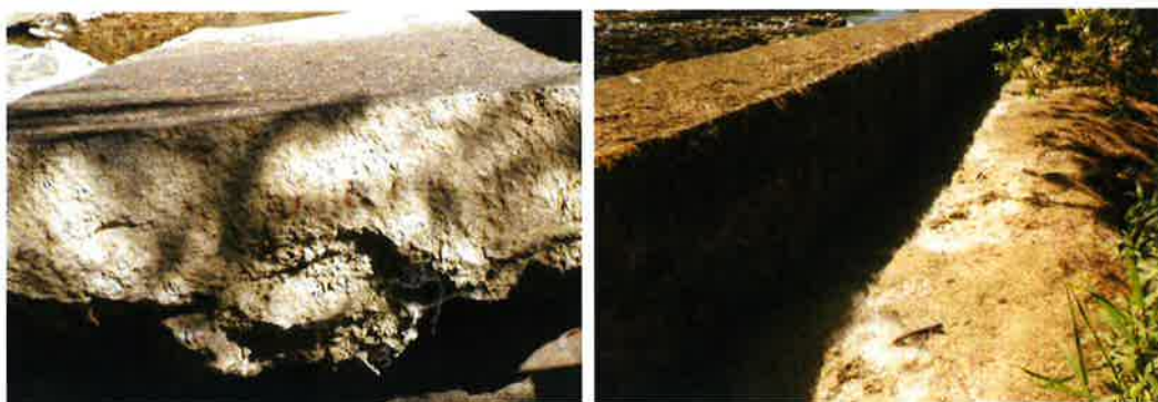
Figure 24. Etat des aciers intégrés à la structure du barrage
