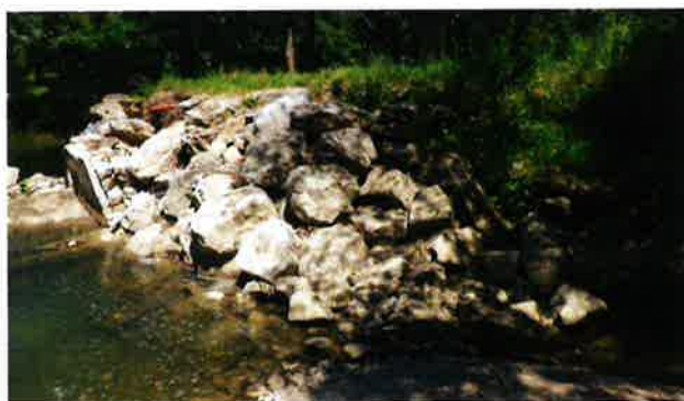
Figure 27. Effondrement partiel de la protection de berge en enrochements
