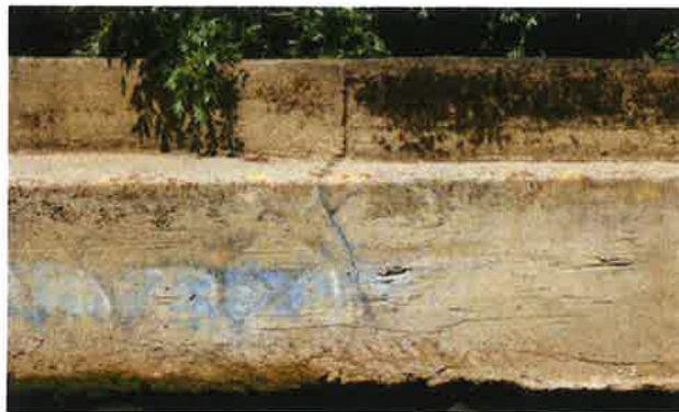
Figure 30. Fissuration du béton
