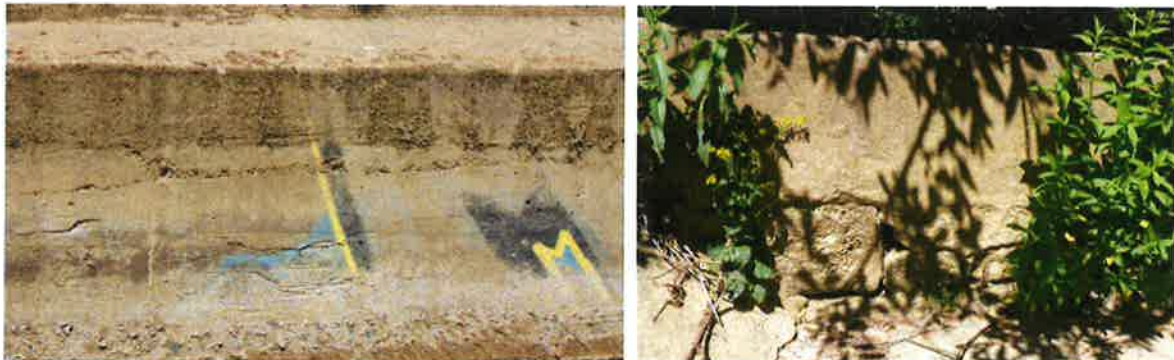
Figure 23. Désordres mineurs et généralisés impactant le béton constitutif du barrage
