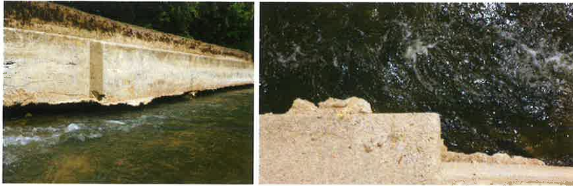
Figure 29. Altération de la semelle en béton
