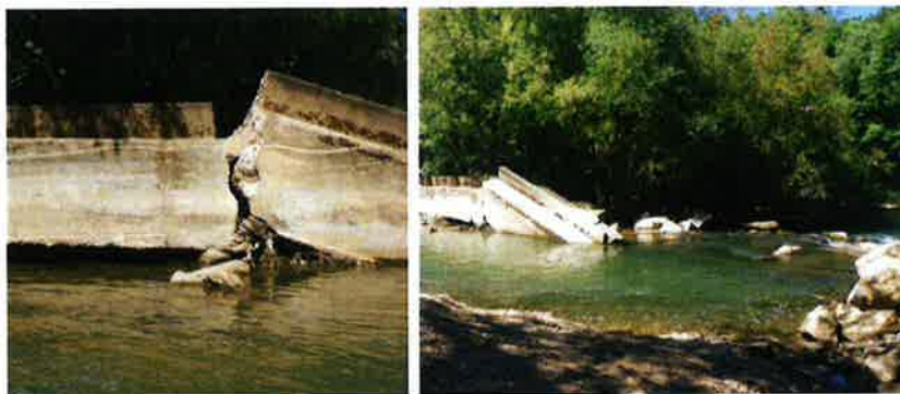
Figure 26. Rupture du vannage et brèche dans le barrage
