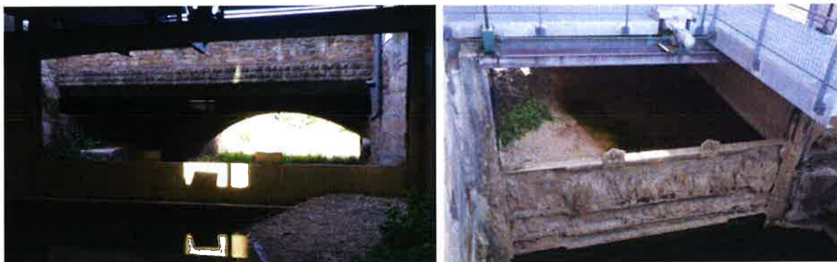
Figure 7. Vues amont (à gauche) et aval (à droite) du vannage de la médiathèque
