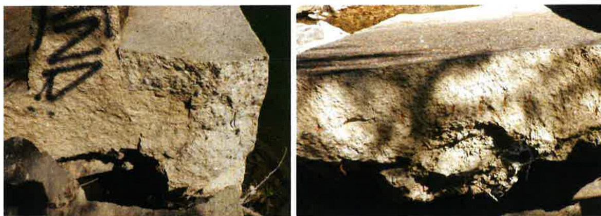
Figure 59. Etat général du béton constitutif du barrage
