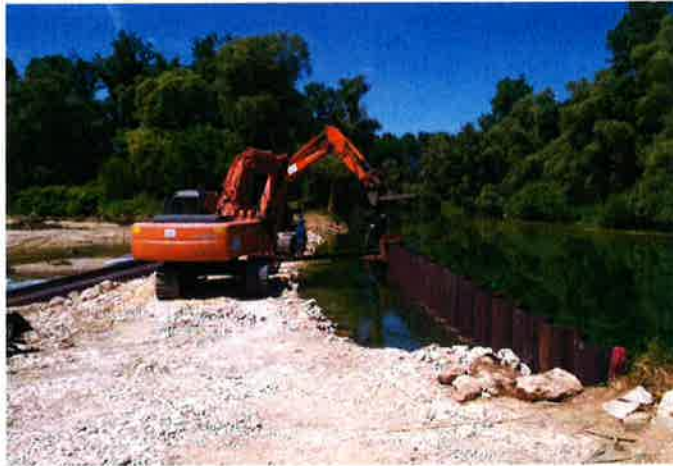
Figure 55. Exemple de batardeau en palplanches utilisé pour la reconstruction du déversoir sur la Loue à Nevy-lès-Dole (39)
